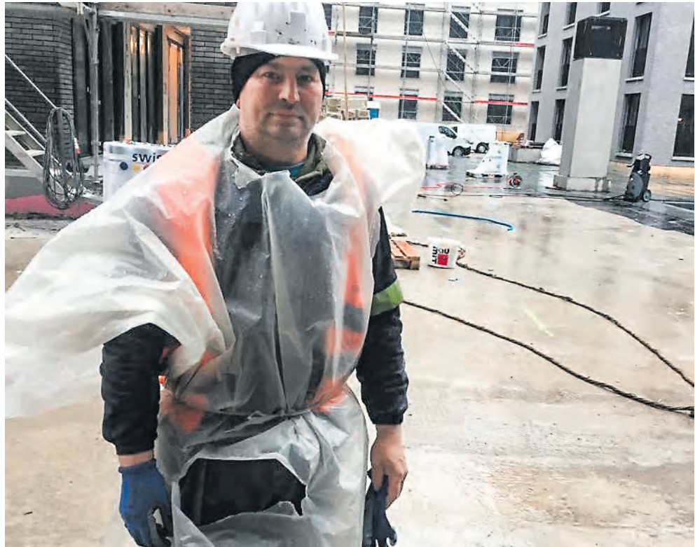
Die rumänischen Bauarbeiter mussten mit völlig ungenügender Ausrüstung und praktisch ohne Sicherheitsvorkehrungen arbeiten. Bild: Cristian Istrati
